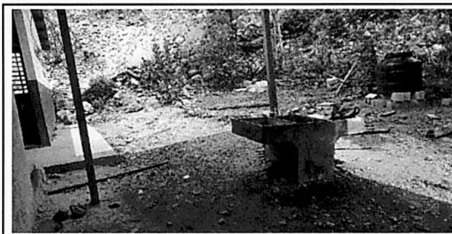
Foto 6. pila de cocina en mal estado y no cuenta con tubería de drenaje para salida de agua
