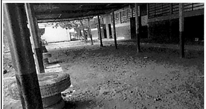
Foto 2. patio no cuenta con piso de concreto
